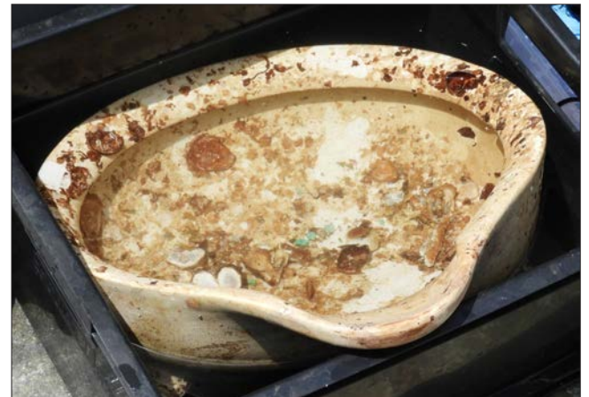
Νιπτήρας από πορσελάνη, προσαρμοσμένος σε ειδική κατασκευή ανάμεσα στις κουκέτες των καμπινών της Β Θέσης και αναδιπλούμενος προς εξοικονόμηση χώρου
